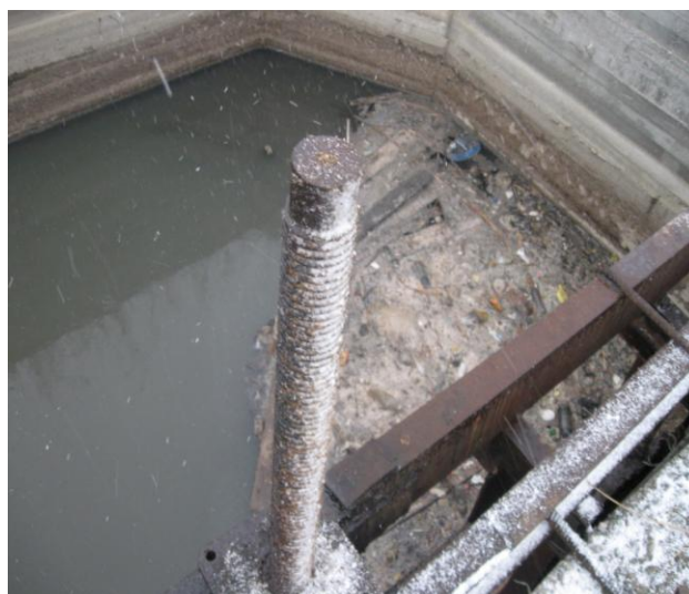
Рис. 4. Городская насосная станция (ГНС).
